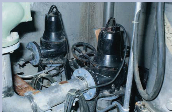
Bombas instaladas verticalmente, con conductos de enfriamiento en estator.
